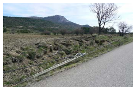
Saint-Auban : des lignes téléphoniques au sol depuis l'hiver 2008
